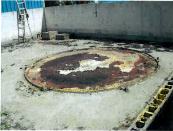
08. Diesel AST bottom
